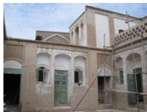
شکل ۱۰- قبل از مرمت نمای داخلی حیاط (مأخذ: آرشیو عکس میراث فرهنگی)
