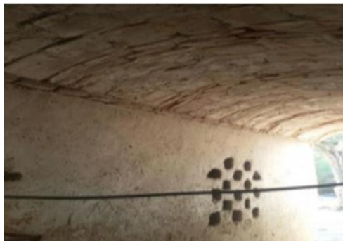
شکل ۱۵ ایجاد حفره هایی در دیوار برای استفاده از نور خورشید به صورت غیر مستقیم و همچنین تهویه مأخذ: دوستی ۱۳۹۴ [۲]
