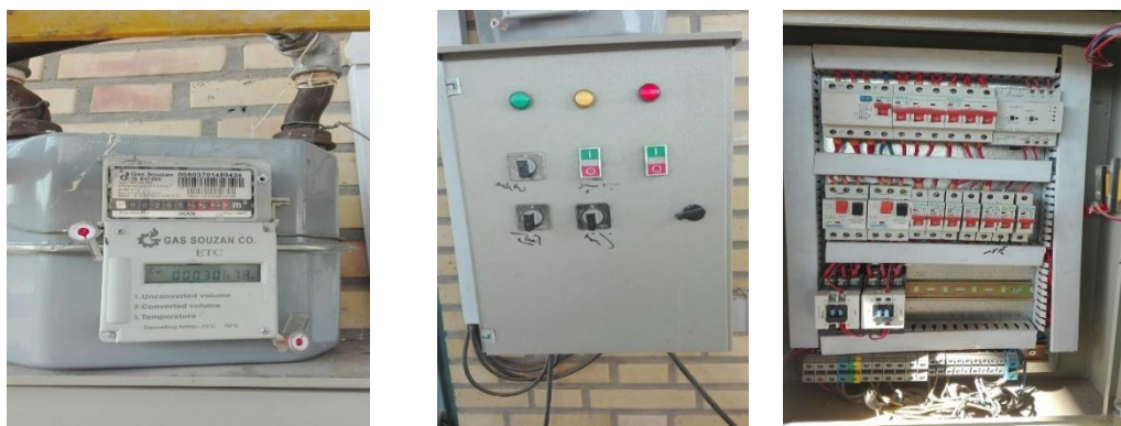
تصویر ۶: از راست نمایش نمای داخلی تابلو کنترل برق، نمای بیرونی تابلو کنترل برق، کنتور گاز
