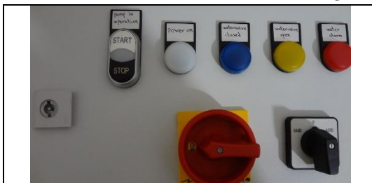
شکل ۱۲- کلیدهای روی درب تابلو کنترل جدید
