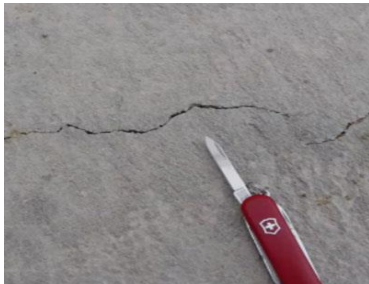
شکل ۲- ترک ناشی از جمع‌شدگی بتن
