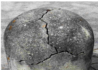
شکل ۴- تخریب ناشی از هوازدگی بتن
