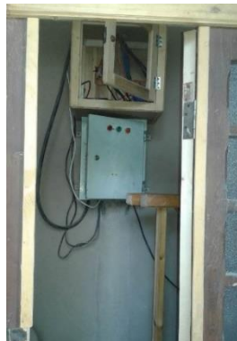
تصویر ۲۱- عدم ساماندهی تابلو برق
