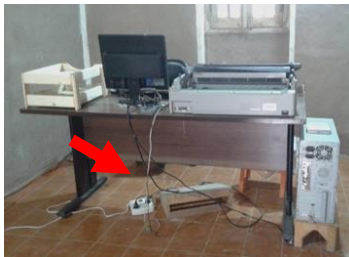
تصویر ۹- نامرتب بودن کابل‌های رایانه
