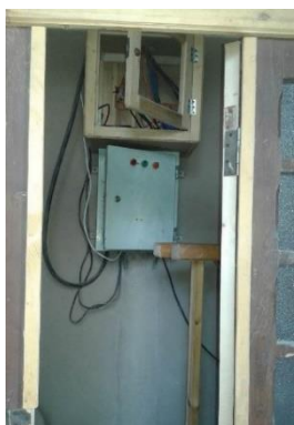
تصویر ۲۱- عدم ساماندهی تابلو برق
