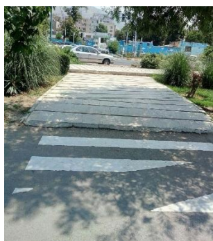
تصویر ۱۰ - کفسازی و اختلاف ارتفاع نامناسب
