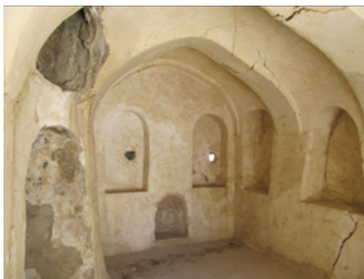
ترک در فضای غربی
