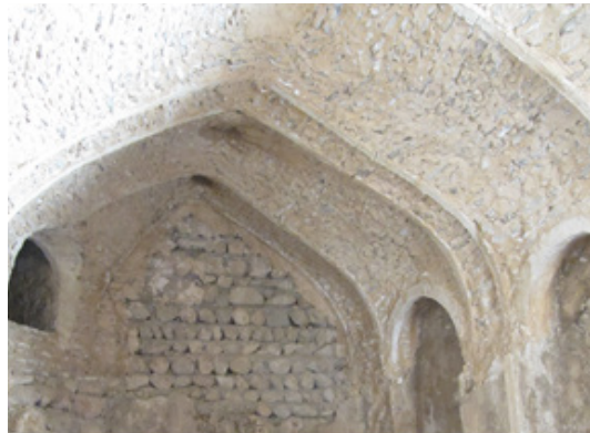
تغییر فرم تاق و تویزه‌ها در فضای جنوب شرقی قلعه
