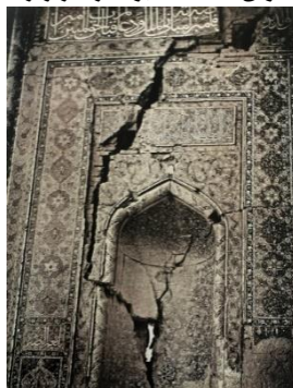
دیوار شرقی ایوان شکست برون صفحه ای
