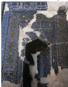
دیوار شرقی ایوان شکست برون صفحه ای
