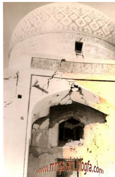
ایوان شرقی امام زاده کاخک ایجاد ترک های برشی
