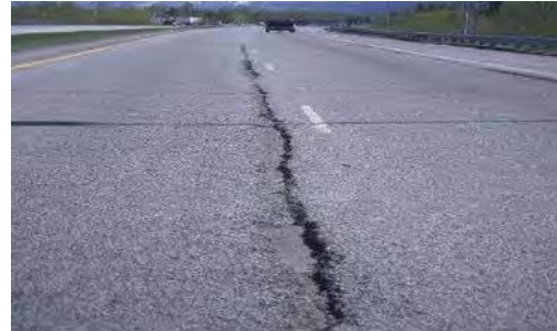
تصویر ۷: خرابی های روسازی آسفالت معابر شهری در ترک های طولی، مأخذ: James & Scherocman, 2007
