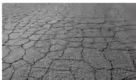
تصویر ۴: خرابی های روسازی آسفالت معابر شهری در ترک پوست سوسماری، عرضی، مأخذ: Coastal road repair pavement repair company. 2014 Roadscience. 2014
