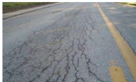
تصویر ۳: خرابی های روسازی آسفالت معابر شهری در ترک پوست سوسماری، طولی، مأخذ: Coastal road repair pavement repair company. 2014 Roadscience. 2014
