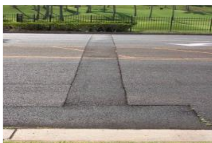
تصویر ۱۴: خرابی های روسازی آسفالت معابر شهری لکه گیری و ترمیم نوار حفاری (وصله)، مأخذ: ASTM D6433. 2007
